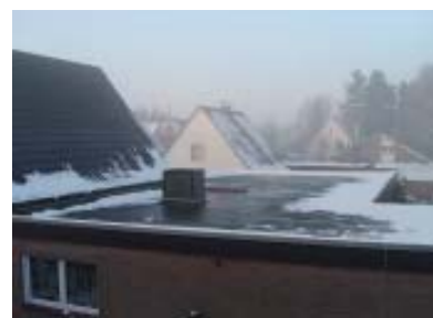
Nicht mehr wirkende Alt-Dämmung evtl. wg. Durchfeuchtung
