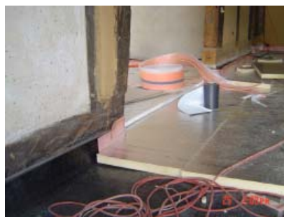
Abb. 2.1.1.1-3 Absenkung einer raumweisen Sohlplatte mit neuer Dämmung in einem Fachwerkhaus mit oberseitig 6 cm PU-Hartschaum
