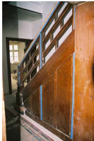
Abb. 2.1.1.3-2 Ungedämmte und undichte Kellertreppenumkleidung, die schwer sanierbar ist
