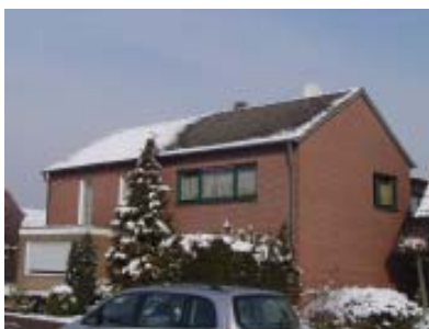
Großflächig fehlende Dämmung bei einer Haushälfte
