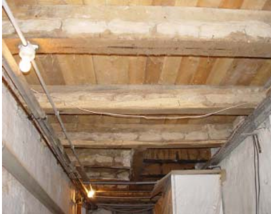
Abb. 2.1.1.4.1-3 Von unten geöffnete Holzbalken-Kellerdecke, in die von unten Dämmstoff eingebaut werden soll
