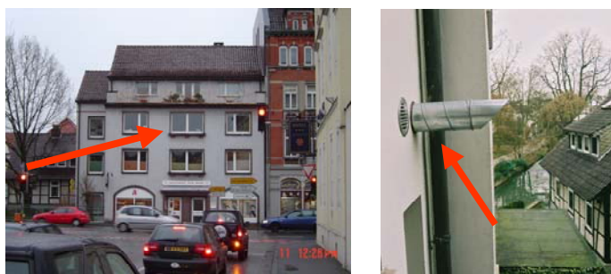
Abb. 2.1.5-5 Nachträglich eingebaute Lüftungsanlage mit WRG in einer mit Außenlärm belasteten Wohnung in der Detmolder Innenstadt
